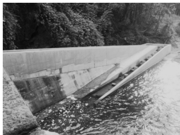
図1 第三砂防堰堤に設置された魚道
