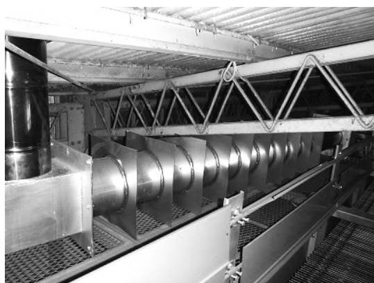
図3 改良型煙突の設置写真
